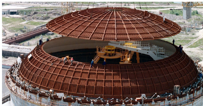
Dohromady konstrukci kontejnmentu vyztužuje 132 ocelových lan. Každé by přitom udrželo tisíc osobních automobilů, je totiž předepjaté silou tisíc tun. Tloušťka lana je 20 centimetrů a je spleteno z 478 ocelových drátů. Délka se pohybuje od 95 do 190 metrů.
